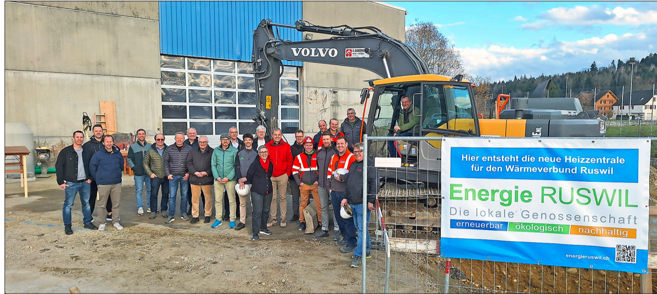
Die bisherig involvierten Personen feiern den Spatenstich im Industriepark Ruswil. Foto Janis Schaller
